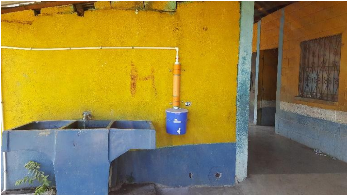
Filtro instalado y listo para ser utilizado por la comunidad educativa.
