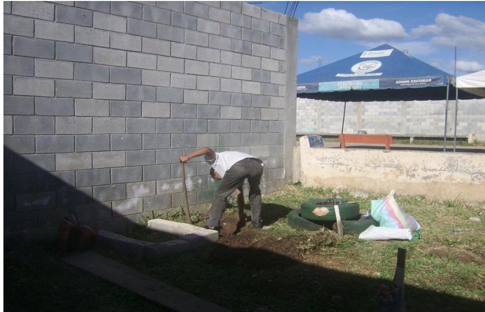
El señor Roque Ambrosio abriendo zanja para la conexión de agua hacia la plantación de árboles, en el INEB Santa Isabel,II.
