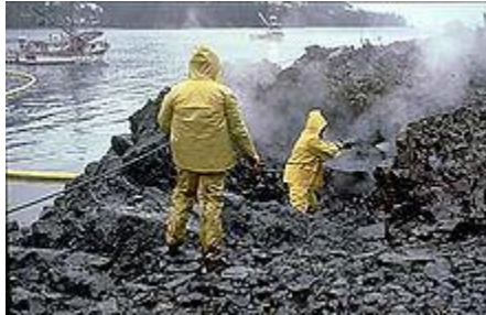
Tareas de limpieza por contaminación debido a vertido de petróleo.
