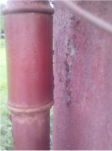
El portón en mal estado
