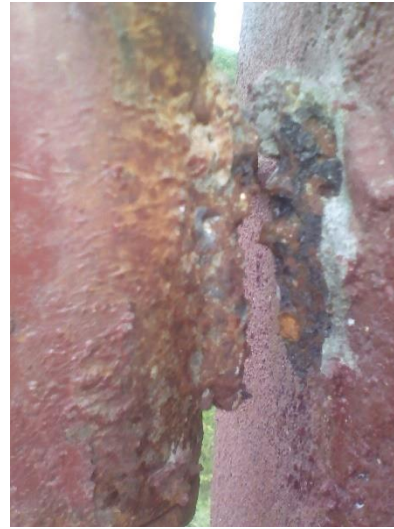
El portón en mal estado
