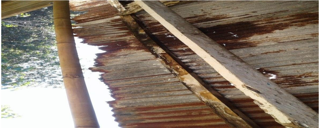
Figura3. Condición del techado
