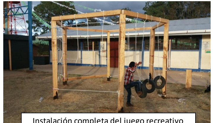
Instalación completa del juego recreativo
