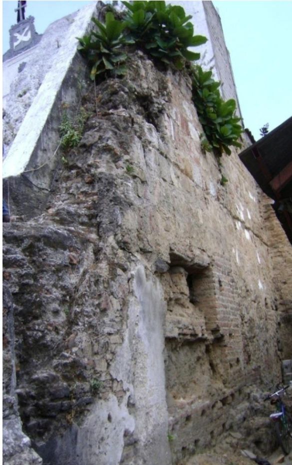
(Ilustración 6. Pared lateral derecha de la iglesia católica que quedó en pie luego del terremoto de 1976. Fuente: CEFOL 2011)
