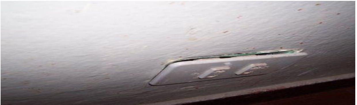
Tomacorriente en mal estado
