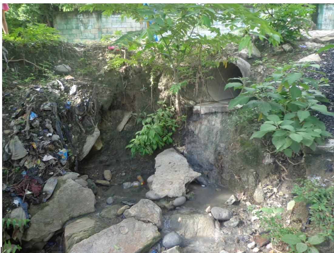
Los drenajes a flor de tierra proliferan olores desagradables y fauna dañina en la comunidad. Fuente: Epesista.
