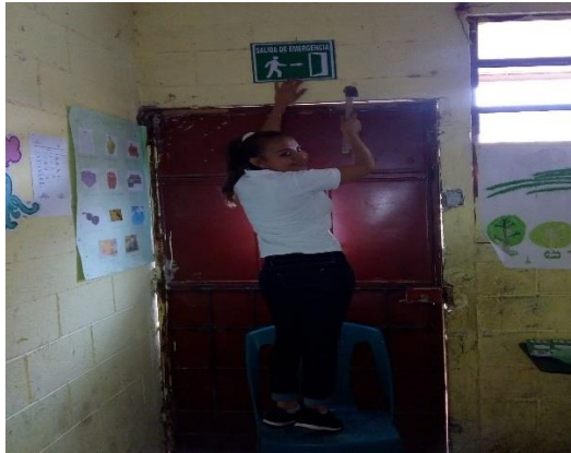
Instalación de salida de emergencia en el Centro Educativo NUFED No. 471 Colonia Los Pinos Jalapa. Fuente: epesista
