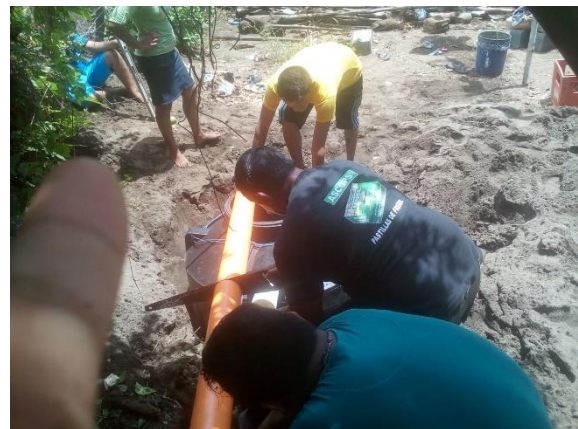
en esta imagen se está midiendo y cortando el tubo PVC. Para luego conectar al depósito.
