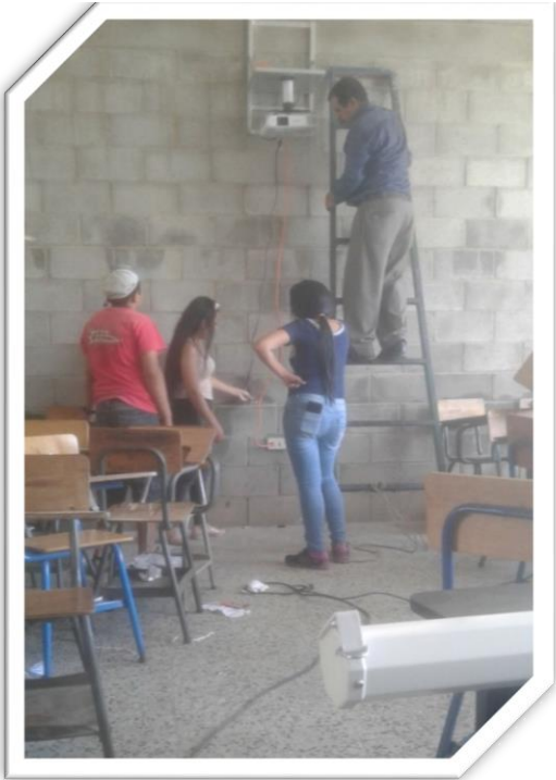
Fotografía No. 13 Ya instalado el proyector se encendió para verificar si quedo bien.
