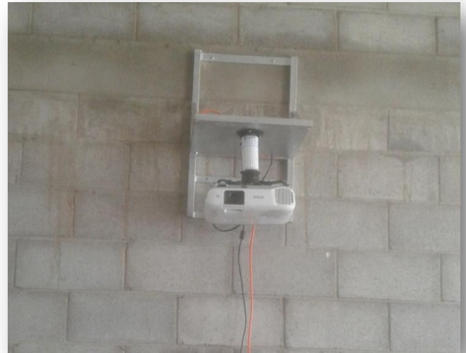
Fotografía No. 6 proyectores instalados en las aulas
