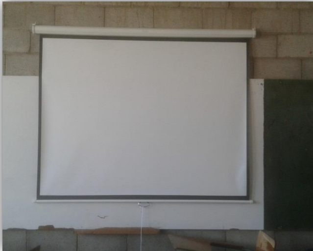
Fotografía No. 5 pantallas para proyectores instalados
