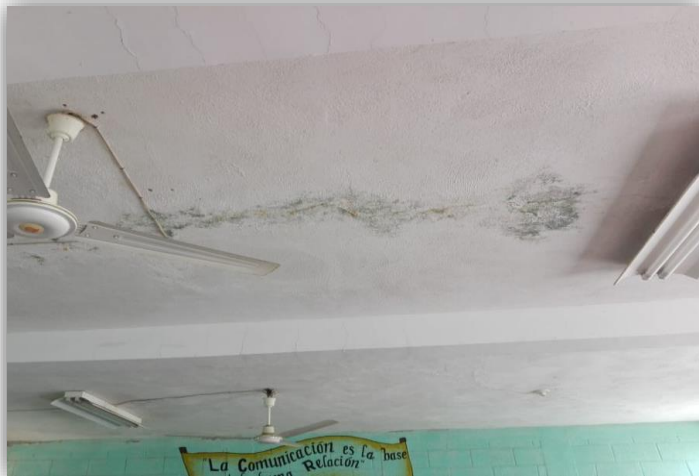
Fotografía No. 1 condiciones adentro del techo del módulo 3
