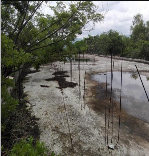
Techo de modulo módulo dañado
