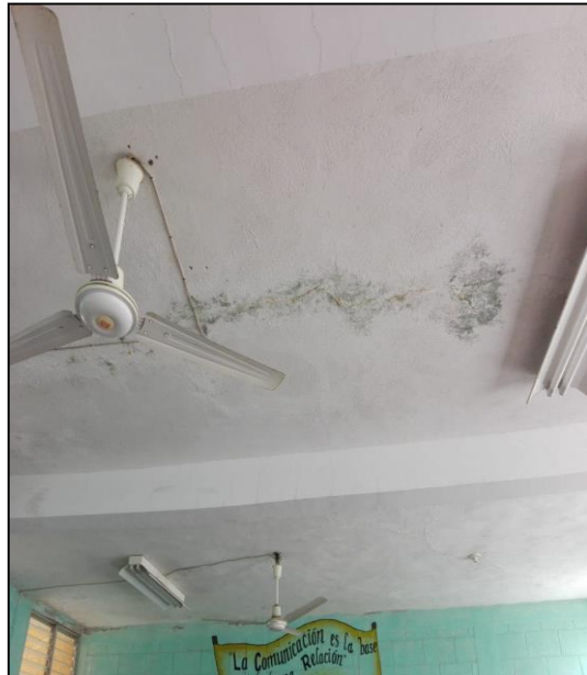
Muestra de techo dañado por la
