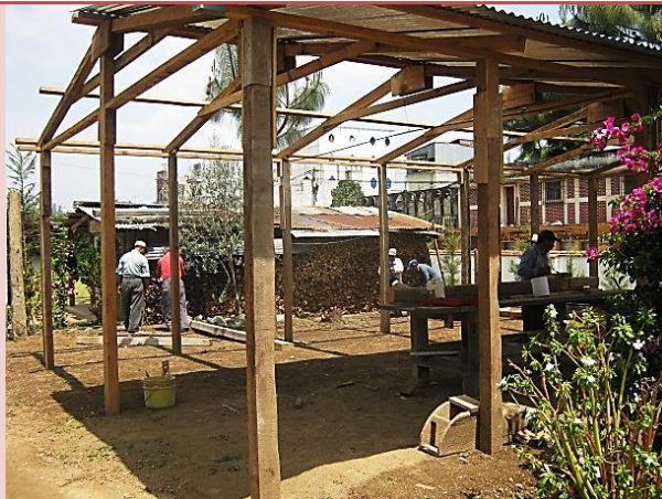
Foto # 59 y 60: Trabajadores preparando la madera, para la restauración del templo. Albañiles y ayudantes siguen las indicaciones del maestro de obra.
