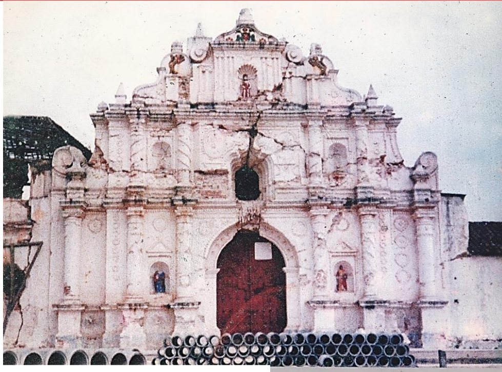
Imagen # 8: detalle del estado de la fachada después del terremoto de 1976. (Foto Archivo Asociación Ruxel B'onil, Comalapa 2018)
