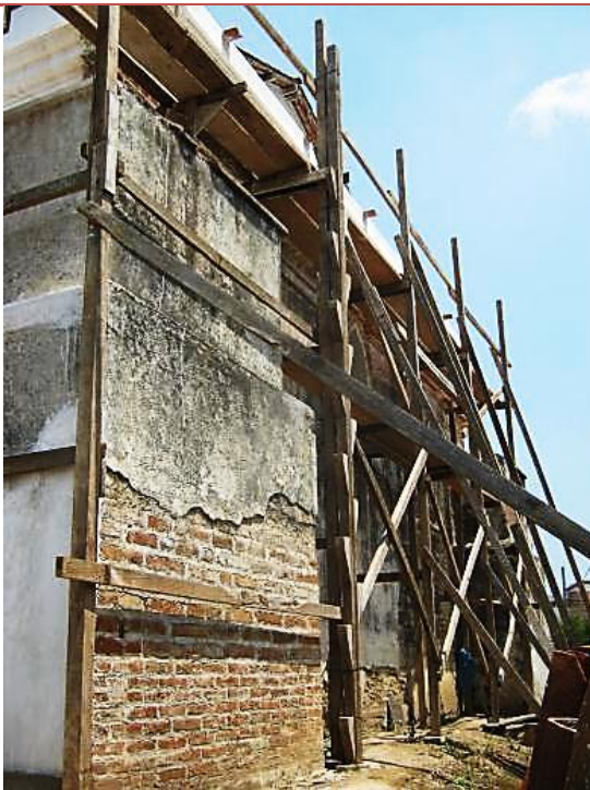
Foto # 63: Afianzamiento de muros y recubrimiento con estuco parte posterior del templo (Chalí, 2018)
