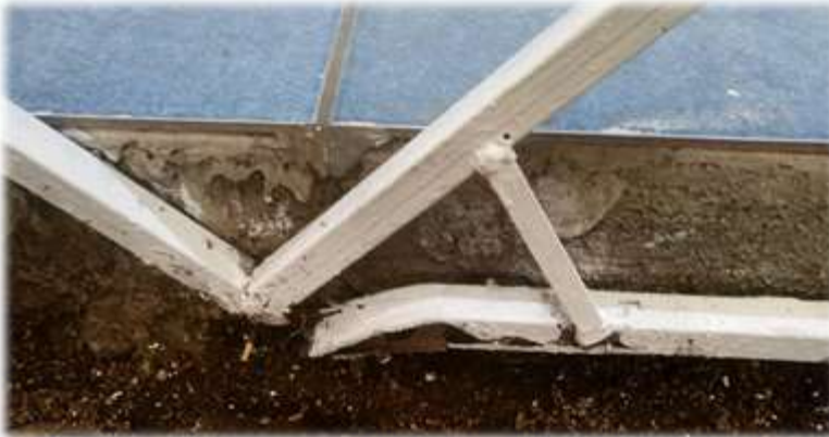
Baranda deteriorada del Centro Cultural de la Facultad de Humanidades.
