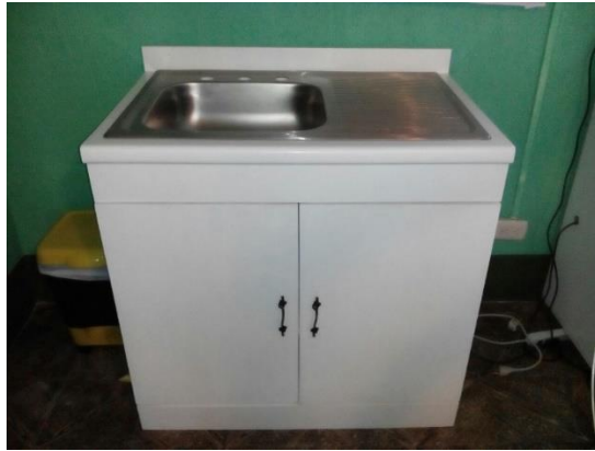
Fotografía 17: lavatrastos de la clínica.
