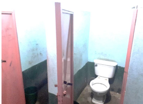
Figura No. 4. Sanitarios de mujeres previo a la remodelación
