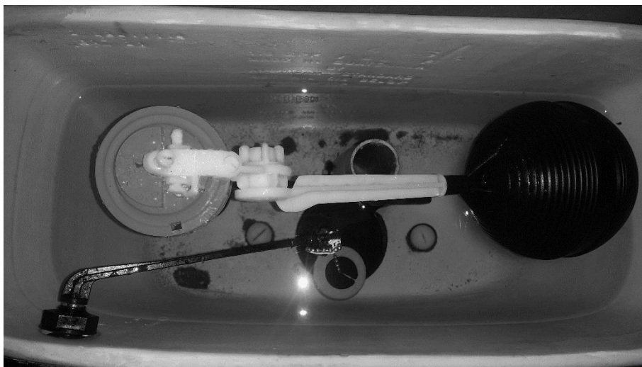
Figura 5. Árbol de flote y sapo instalado en uno de los 3 baños. Fuente: EPS 2017 – 2018, Aldea El Aguacate, Nentón, Huehuetenango.
