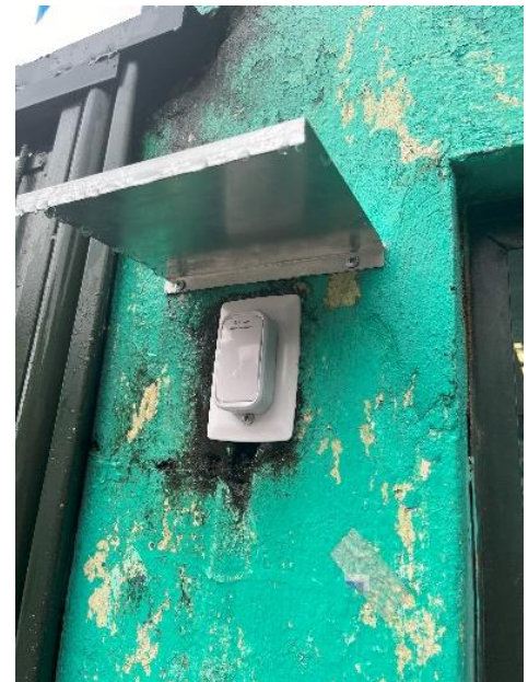
Imagen 8. Timbre inalámbrico para exteriores instalado en la puerta de la escuela con techo de lata para protección de sol y lluvia.
