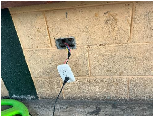
Imagen 5. Estado de tomacorrientes en aula.
