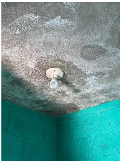
Imagen 3. Filtración de agua en el techo del baño de maestras.
