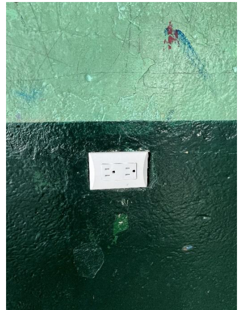
Imagen 10. Tomacorriente instalado correctamente, disminuyendo el riesgo de accidentes.
