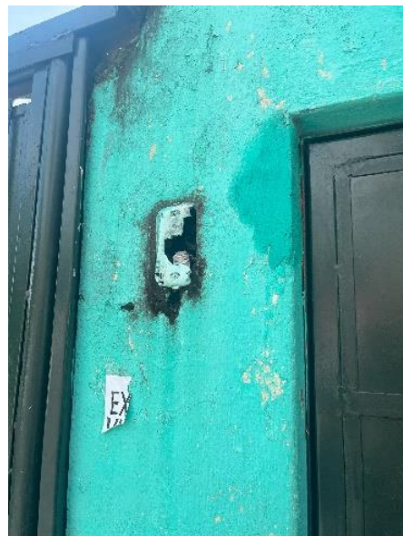
Imagen 2. Instalación antigua del timbre de la puerta de la escuela, dos años sin funcionamiento
