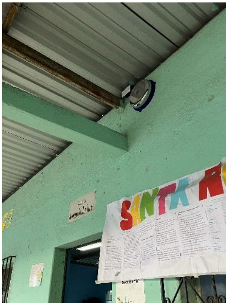
Imagen 7. Timbre de campana para uso de jornada vespertina instalado.
