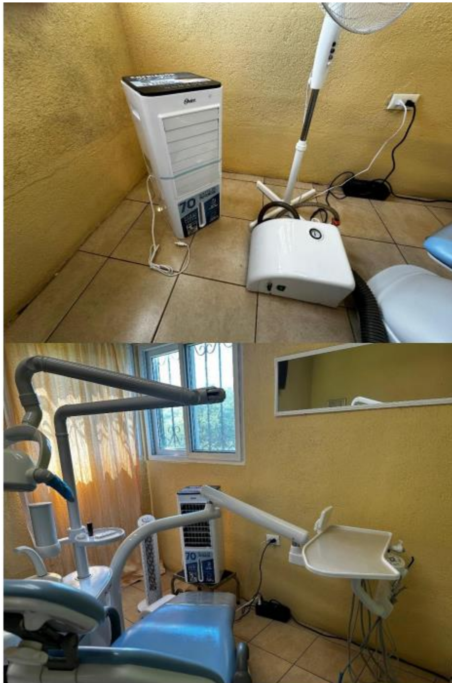
Imagen 15. Instalación de aire acondicionado portátil en el interior de clínica dental.
