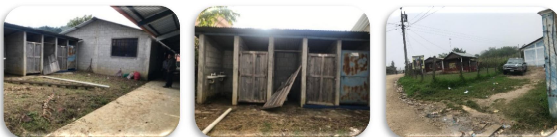
Imagen 1. (Proyectos comunitarios, estado inicial. Puertas de baños y portón de entrada principal)
