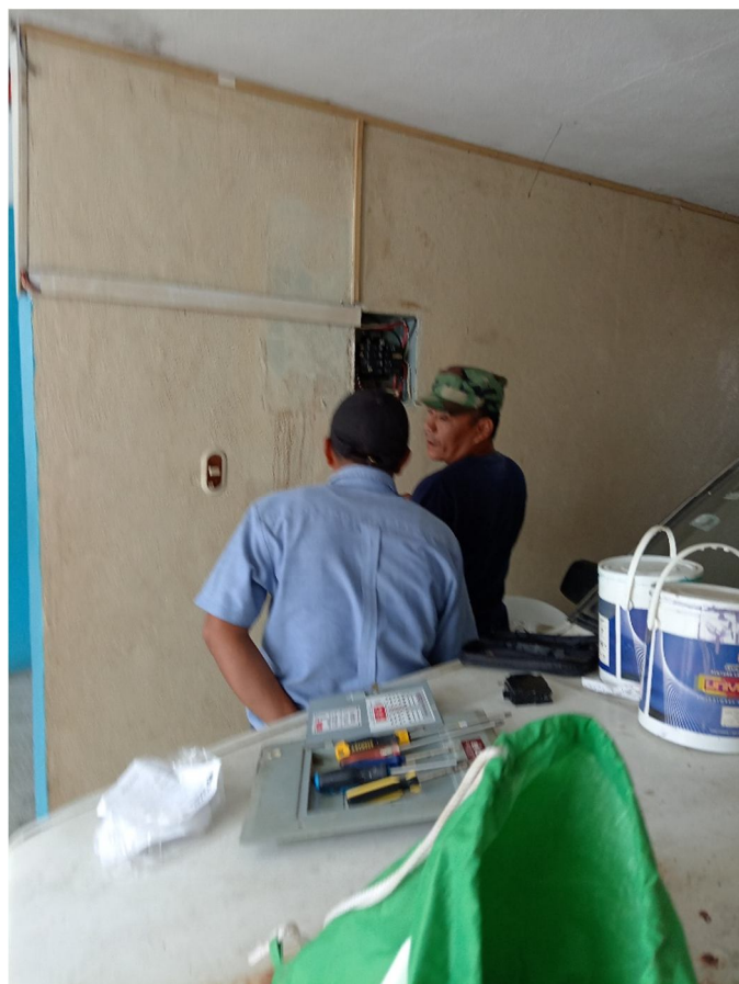
Figura 87. Cambio de flipones de la caja central.
