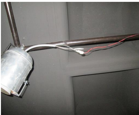
Instalaciones eléctricas no adecuadas en la iluminación
