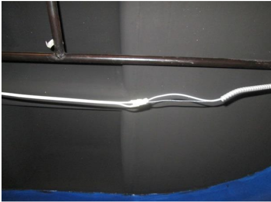
Cableado antiguo de las luces del Estudio de Tv
