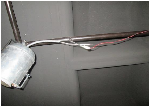
Sistema de iluminación análoga
