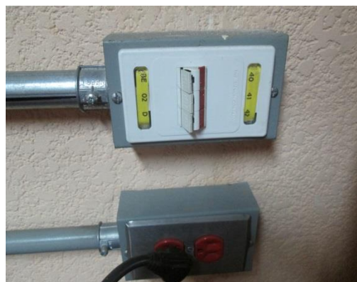
Conector de 3 salidas de señal para internet activado, Cabina del estudio
