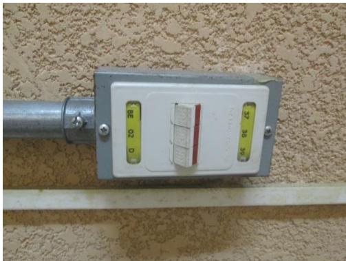
Conector de 3 salidas de señal para internet activado, Camerinos
