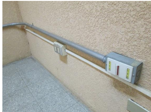
Conector de 3 salidas de señal para internet activado, sala de edición
