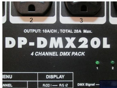
Sistema de dimers digitales instalados
