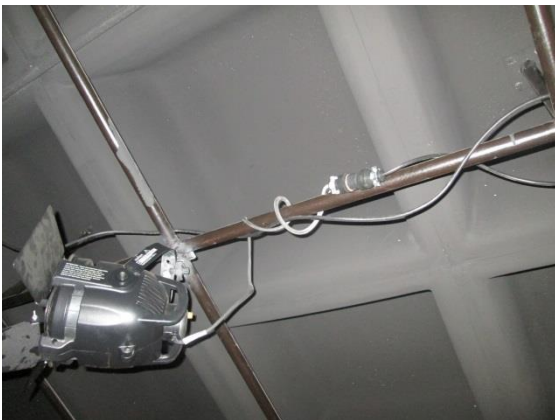
Cableado actual de las luces del Estudio de Televisión
