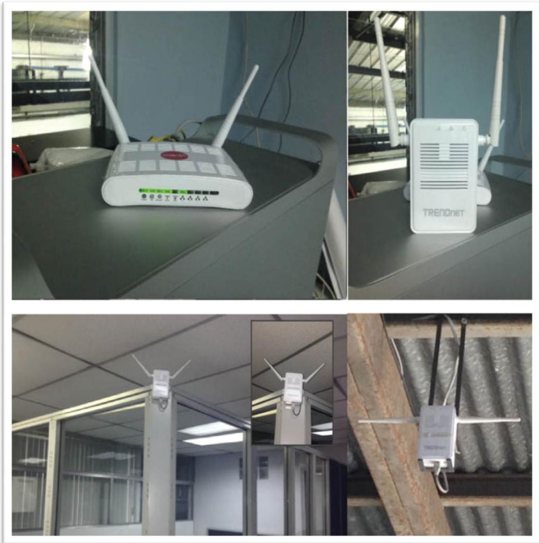
Fotografía: Mynor Ramírez, Localización de Antenas wifi y servicio de internet en Envases Desechables Centroamericanos,S.A. agosto de 2016. Instaladas en Área de impresión, Administración y Oficinas de Producción.
