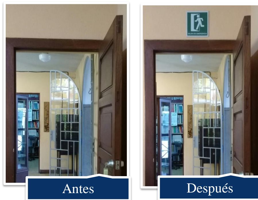
Señalética de emergencia en puerta Fuente: Elaboración propia.
