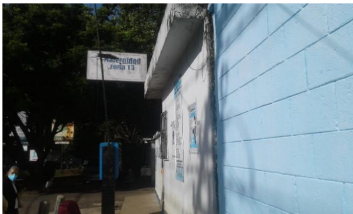
FIGURA 15 RÓTULO DETERIORADO DE LA MATERNIDAD
