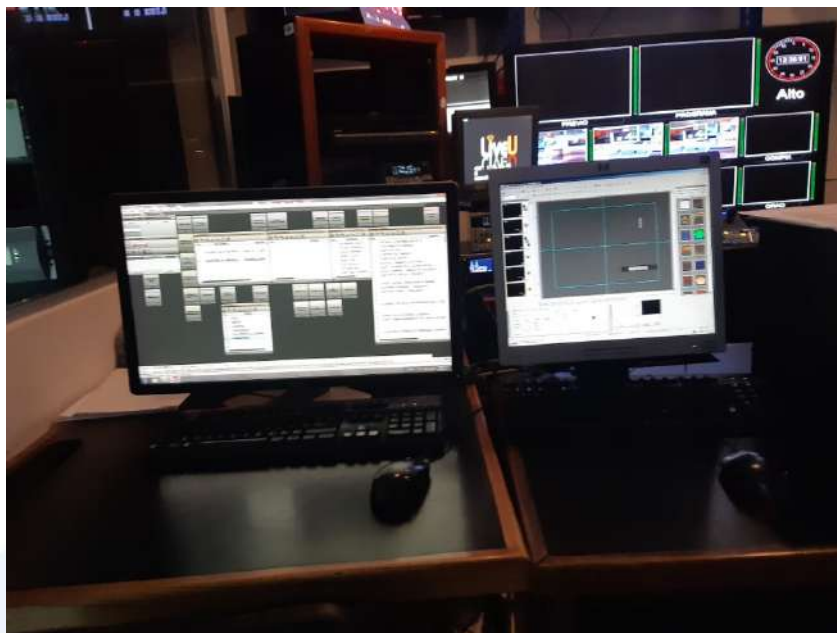
Figura 32 Equipo de generador de caracteres
