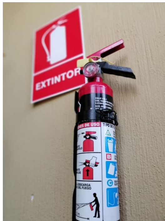
Figura 7: Fotografía de señalización para uso de emergencia
