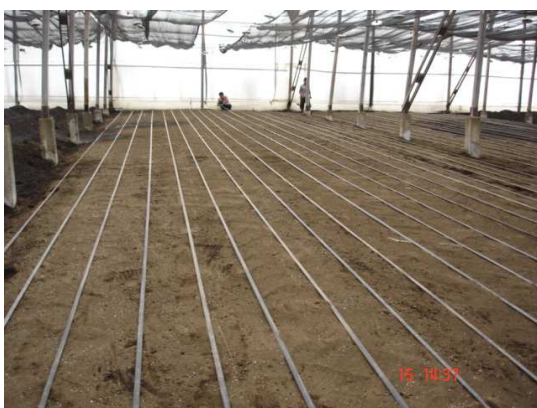
Figura 5. Colocación de cinta de goteo para aplicación de Metam sodio y 1,3 Dicloropropeno
