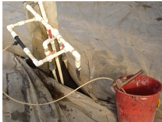
Figura 15. Adaptación del Venturi para inyección del producto en el riego por goteo
