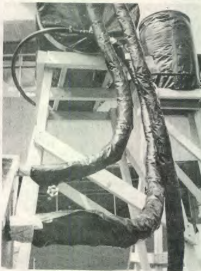
FIGURA 21 Vista de los acoples de la tubería aislada y las válvulas de control de paso de agua caliente hacia el Acumulador de Calor.
