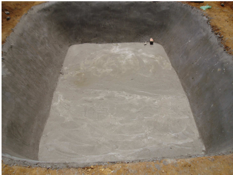
Figura 2.35A Pozo artesanal concluido con el repello fino en las paredes y el piso.
