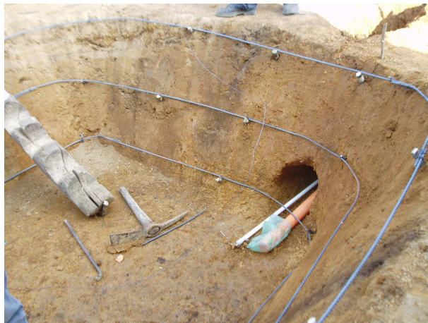
Figura 2.32A Colocación de los tres anillos de hierro en las paredes del pozo, uno en la parte superior, el segundo en la parte media y el último en el fondo del piso.
