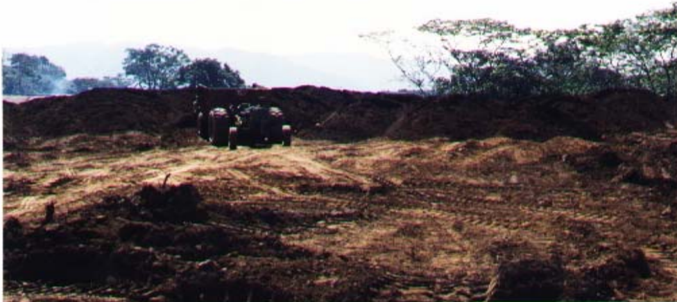
Foto 20 Remoción de suelo fértil y posteriormente aprovecharlo para jardinerización de arriate central y distribuidor de tráfico.
