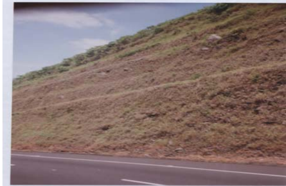
Foto 7 Talud mostrando vegetación natural sin reforestar.
