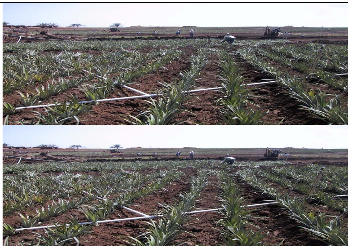
Figura 11A: Instalación de riego en piña, finca La Plata, Coatepeque, Quetzaltenango
