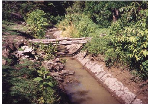
Fotografía No. 6: Aspecto General de los canales secundarios, en ellos se puede observar un mal estado, demasiado azolve y malezas.
