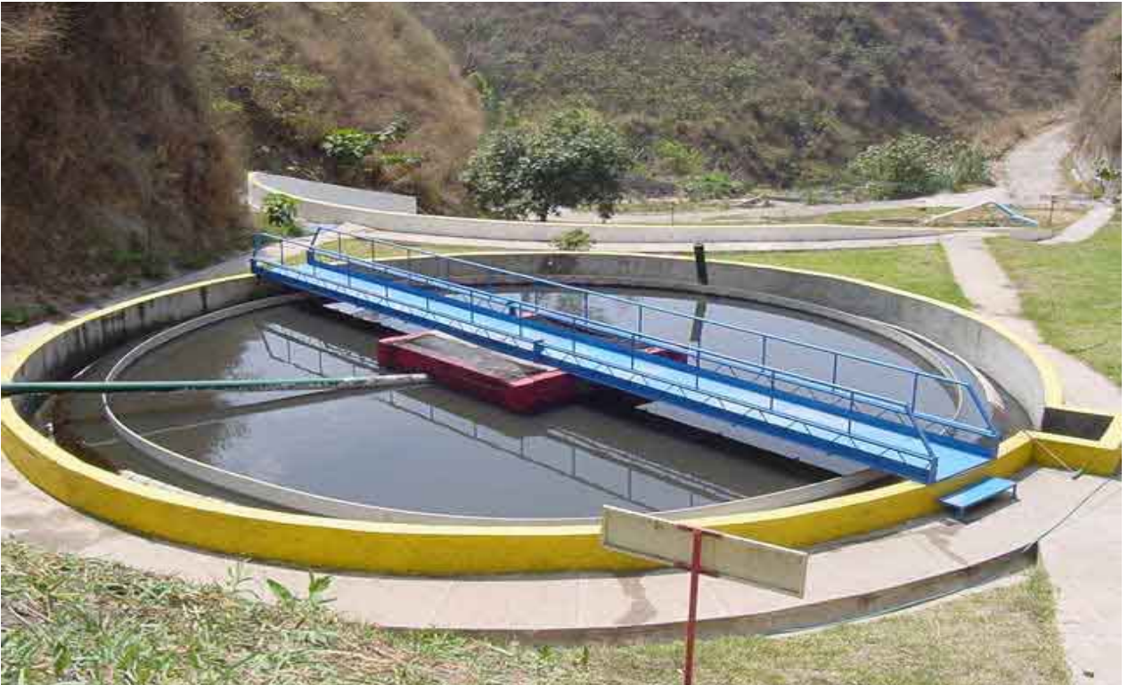
Digestor de lodos.
