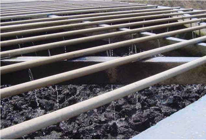
filtros percoladores (biológicos)
