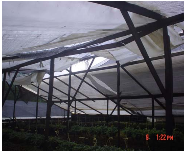
Figura 14A. Invernadero en malas condiciones que necesitaba mantenimiento, finca Bella Vista 2004.
