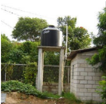
Figura 3.27. Tanque de captación
