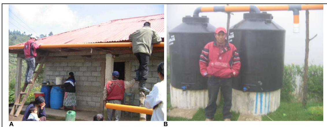
Figura. 3.2 Instalación de tuberías en el techo de las casas. A) Instalación de tubería, casa de doña Timotea Ramos. B) Sistema instalado. Fotos: Vitalino Méndez.
