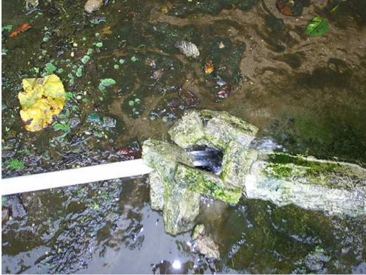
Figura 25 A. Tanque de Captación de agua Xemprino.
