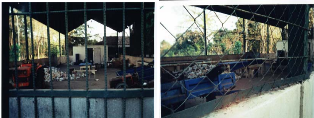
Figura 68 Estado inicial del cuarto frío al iniciar el EPSA.
