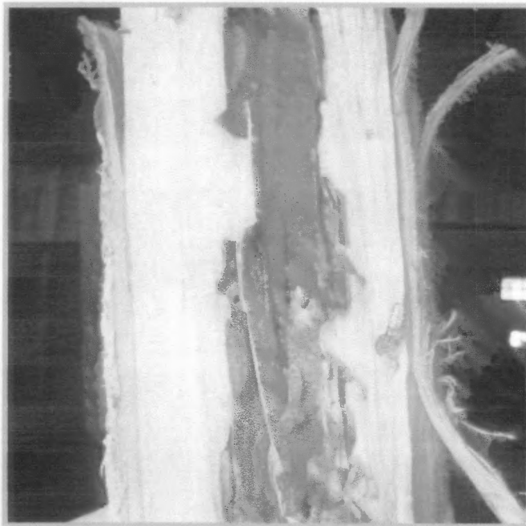
Figura 37 Trozo de madera de teca ( T. grandis L.f.) dañada por termitas
