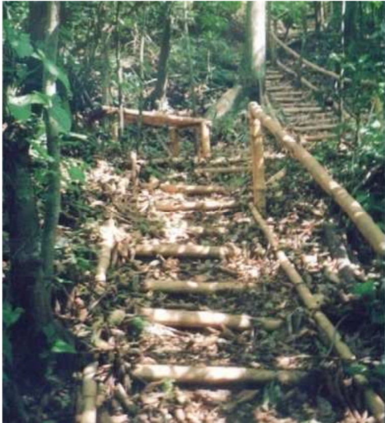
Figura 16. Escalinata de bambú, donde el material vegetal circundante se acumula y es necesaria su limpieza periódica.
