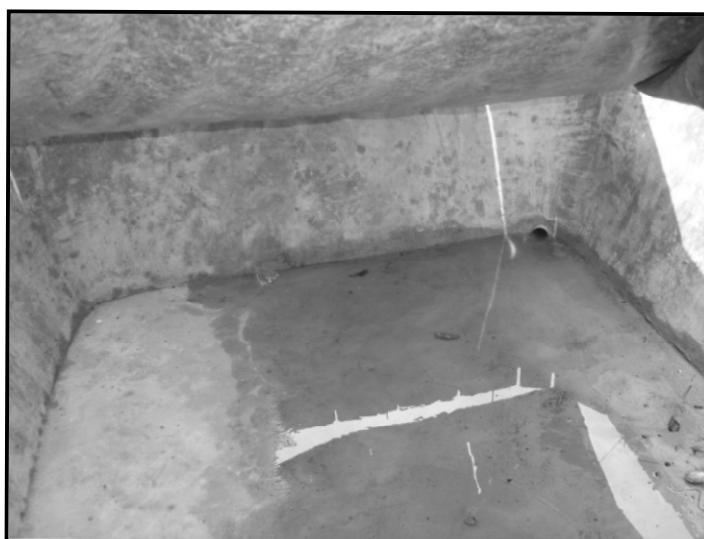
Figura 3.28 Tanque de captación de agua de lluvia en la comunidad de El Jute I, Purulhá, B.V.
