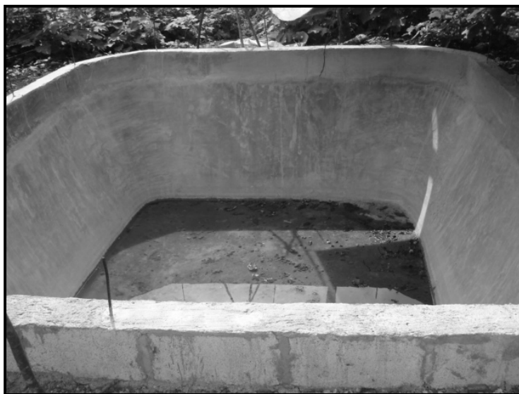
Figura 3.27 Tanque de captación de agua de lluvia en la comunidad de Eben Ezer, Purulhá, B.V.
