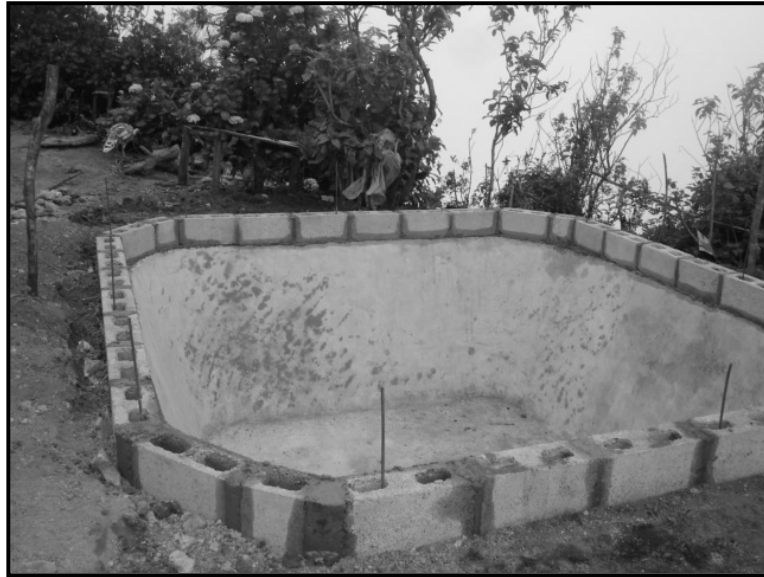
Figura 3.29 Tanque de captación de agua de lluvia en la comunidad de El Jute II, Purulhá, B.V.
