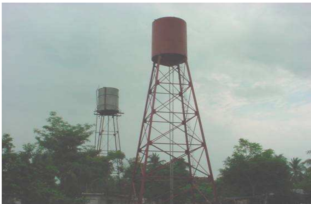
Figura 5. Tanque del Proyecto del Agua Potable.
