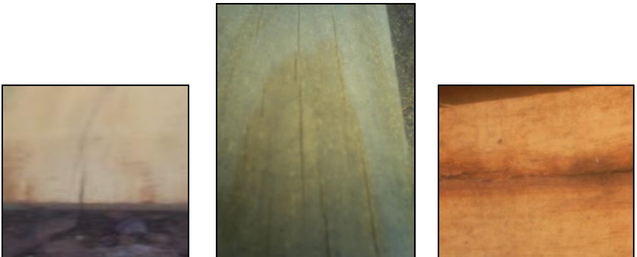
Figura 32. Algunos ejemplos de rupturas (grietas y rajaduras) identificadas en los productos de ASILCOM 2008.
