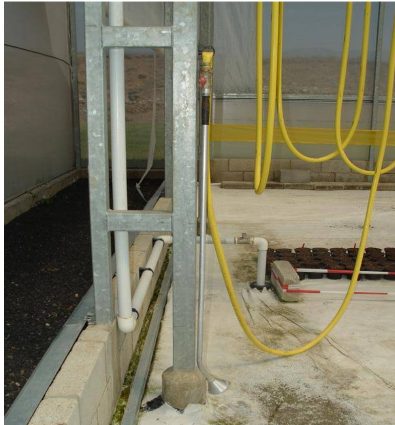
Figura 47. Estado en el que se encontró el sistema de fertirriego.
