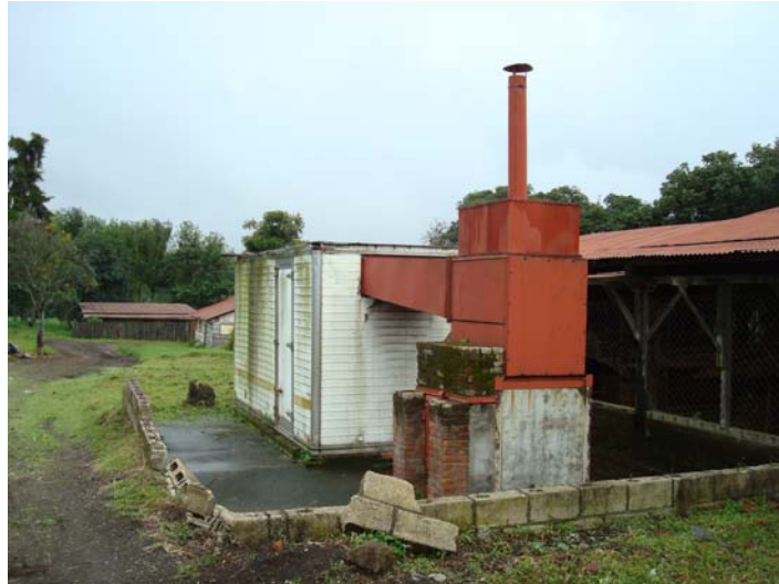
Figura 5. Vista exterior de la secadora utilizada en el secado de madera, Aserradero San Sebastián.
