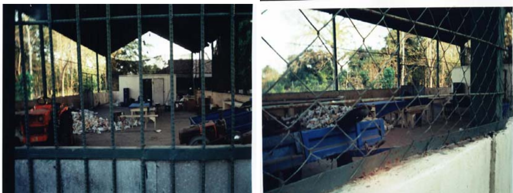
Figura 57. Estado inicial del cuarto frío al iniciar el EPSA.
