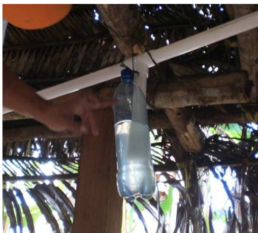
Figura 32. Respiradero o válvula de escape del biodigestor
